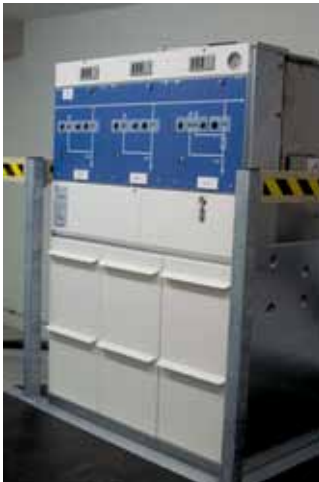
Hochspannungszellen in der Transformatorstation Mühleweg, Ehrendingen
