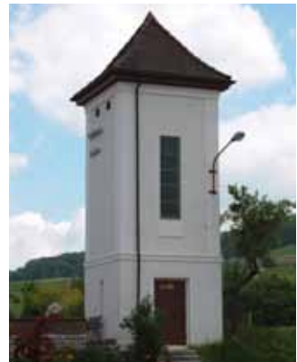
Transformatorenstation Dorf, Ehrendingen
