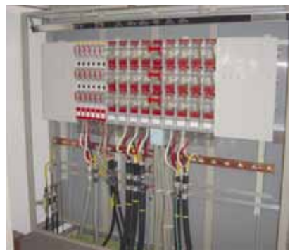
Niederspannungsverteilung Messstation Kindergarten, Freienwil
