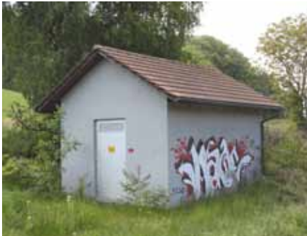
Transformatorenstation Chaltebrunne, Freienwil
