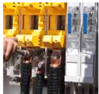
Kabelverteilkabine Klonhof Kabelanschluss
