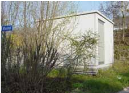
Oben: Transformatorstation lfang, Ehrendingen
