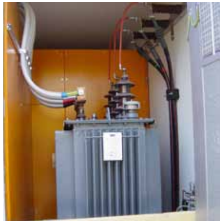
Rechts: Transformator in der Transformatorstation lfang, Ehrendingen
