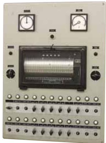
Steuerung Netzkommandoanlage aus den sechziger Jahren
