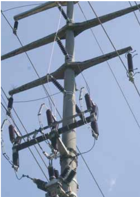
Abgang für die Elektra Ehrendingen von der Hochspannungsleitung Baden-Bezau
