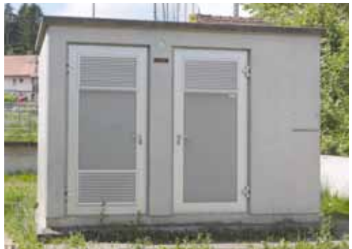
Transformatorenstation Dorf, Freienwil
